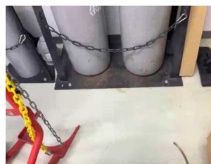
高圧ガスボンベの固定
